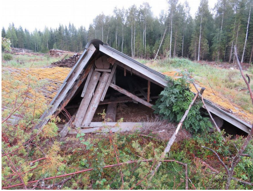
Miilun lähistöllä sijaitsevan romahtaneen rakennuksen kattorakenteita koilliseen.
