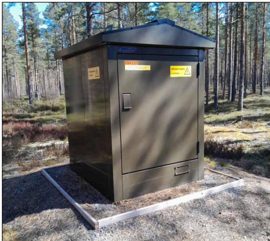
Kuva 19. Puistomuuntamo Pyssykankaan pohjavesialueella.
