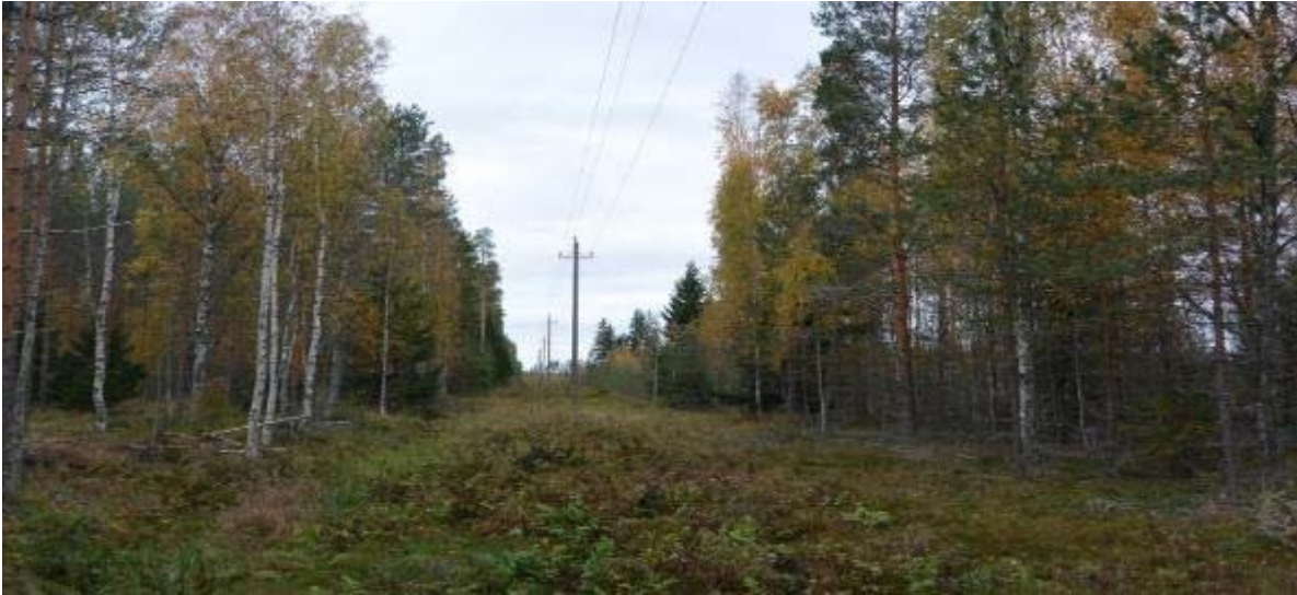
Kuva D. Sähkölinja
