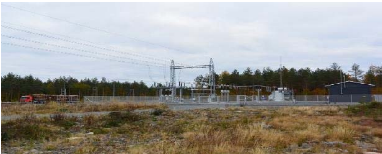
Kuva F. Sähköasema
