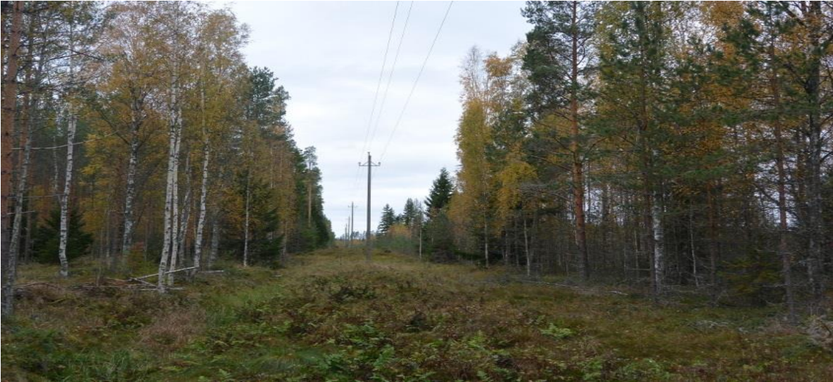
Kuva D. Sähkölinja
