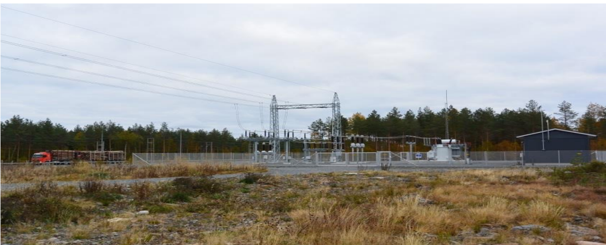
Kuva F. Sähköasema
