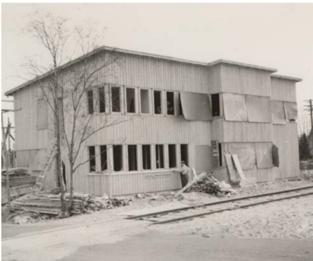
Kaksikerroksinen, pienikokoinen rakennus radan varressa. Vaununjakajan toimisto Seinäjoen asemalla. Osa ikkunoista on peitetty pahveilla, muutkin ovat rikki. Tarpeettomaksi jäänyt rakennus. Kuvattu keuhällä vuonna 1960. Seinäjoen maakuntakokoelma. Kuvanunero: 852.
