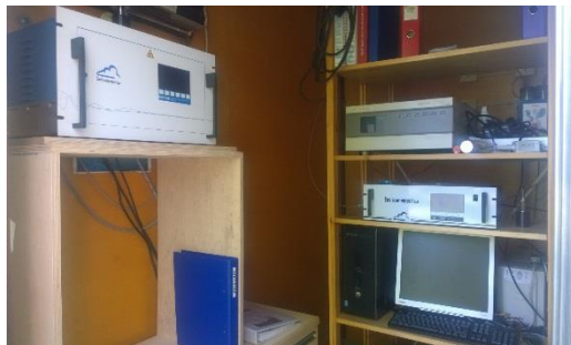
Kuva 6. Seinäjoen mittausaseman laitteisto.
