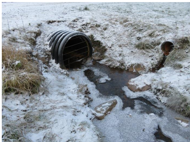
Kuva 4. Putkitetun Kivipuron osuuden alkukohta lähellä Purokujaa (ks. Kuva 5). Alueella on esiintynyt hulevesitulvia.
