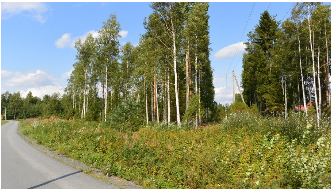
Kuva L. Sähkölinja Puuttomantieltä pohjoiseen
