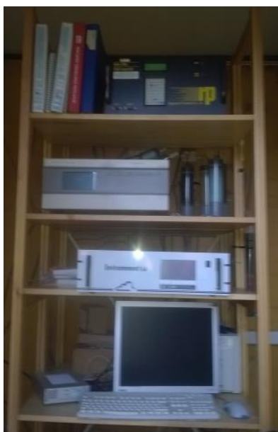
Kuva 6. Seinäjoen mittausaseman laitteisto.
