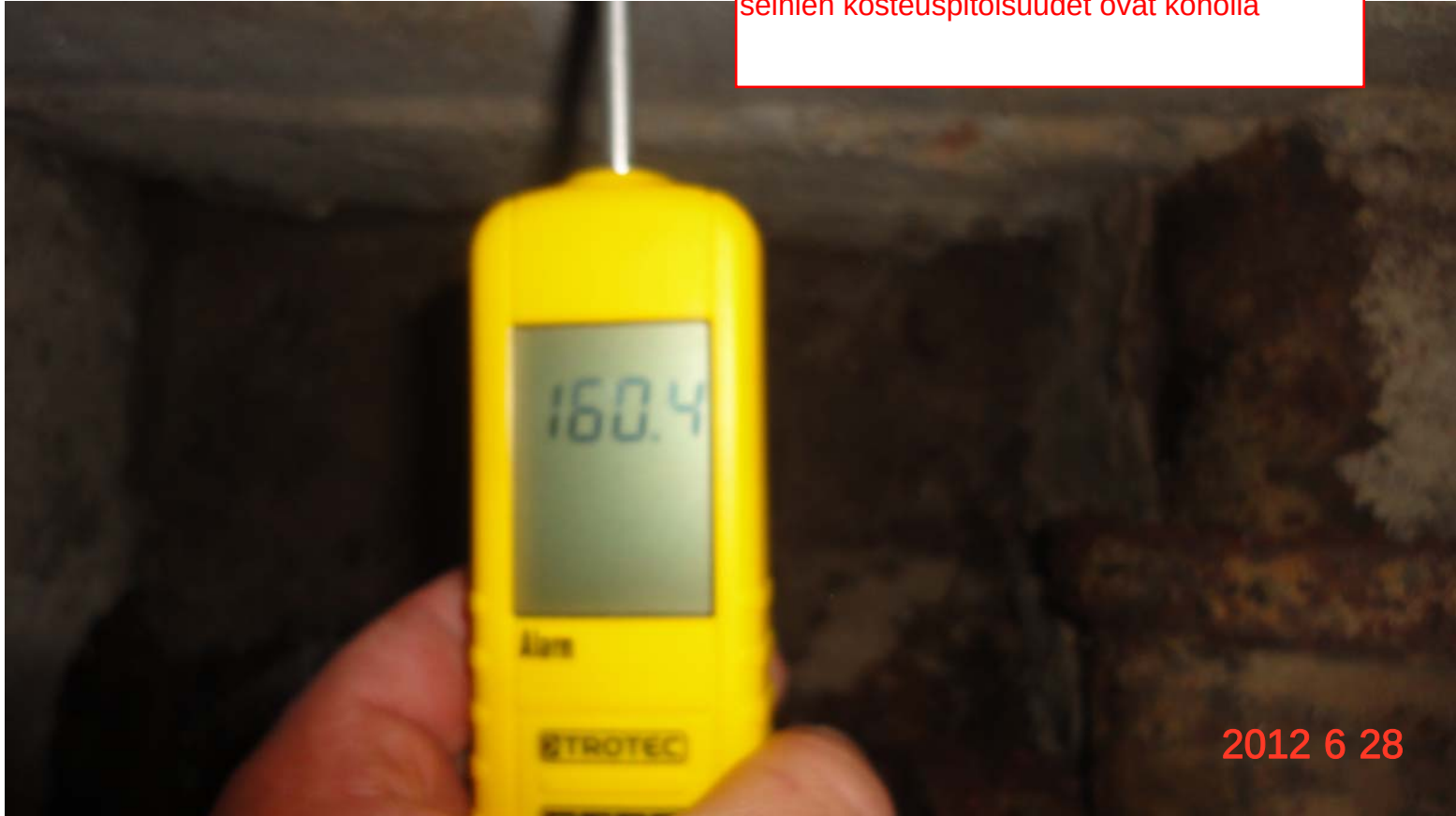
Kellarin lattialuukkujen lattioiden alapuolisten seinien kosteuspitoisuudet ovat koholla
