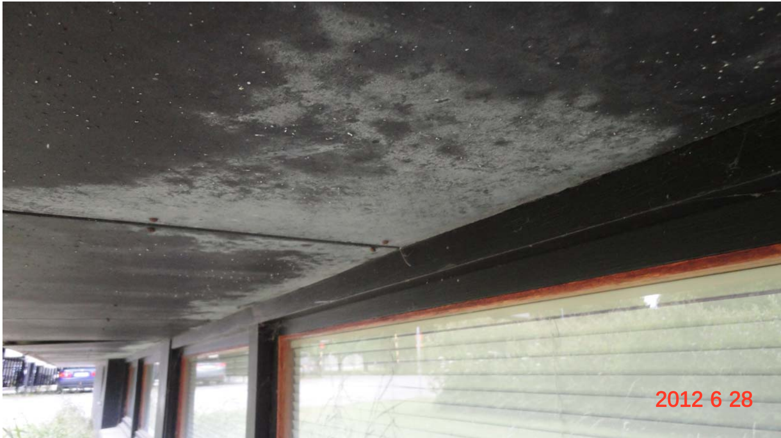
Kosteusvaurioita seinän sisäänvedon päällä
