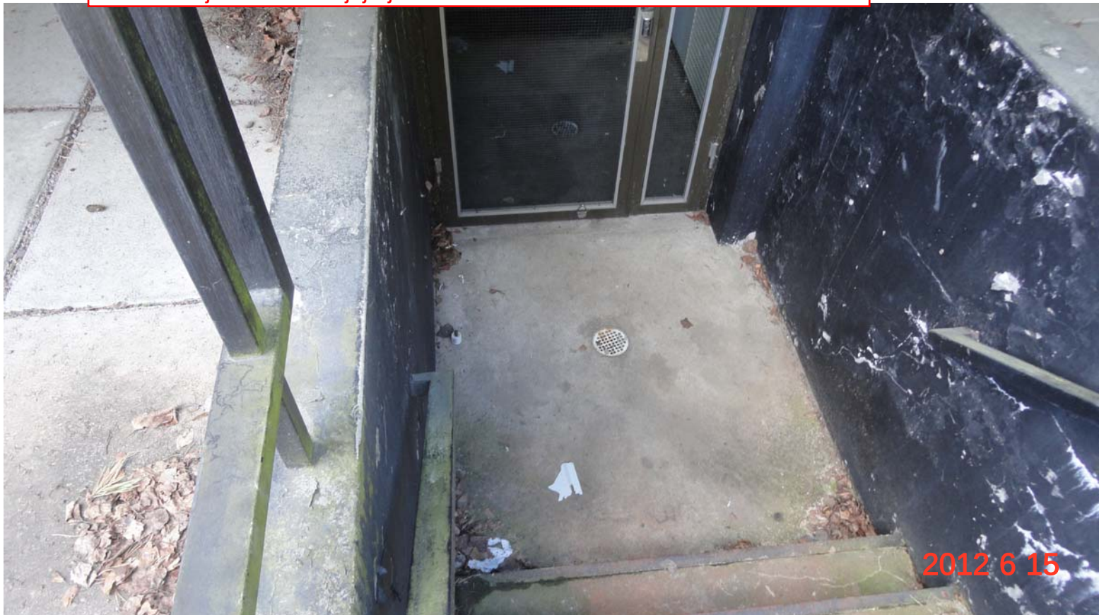
Porrassyvennysten betonipinnat heikossa kunnossa. Sadevedet johtuvat salaojajärjestelmään
