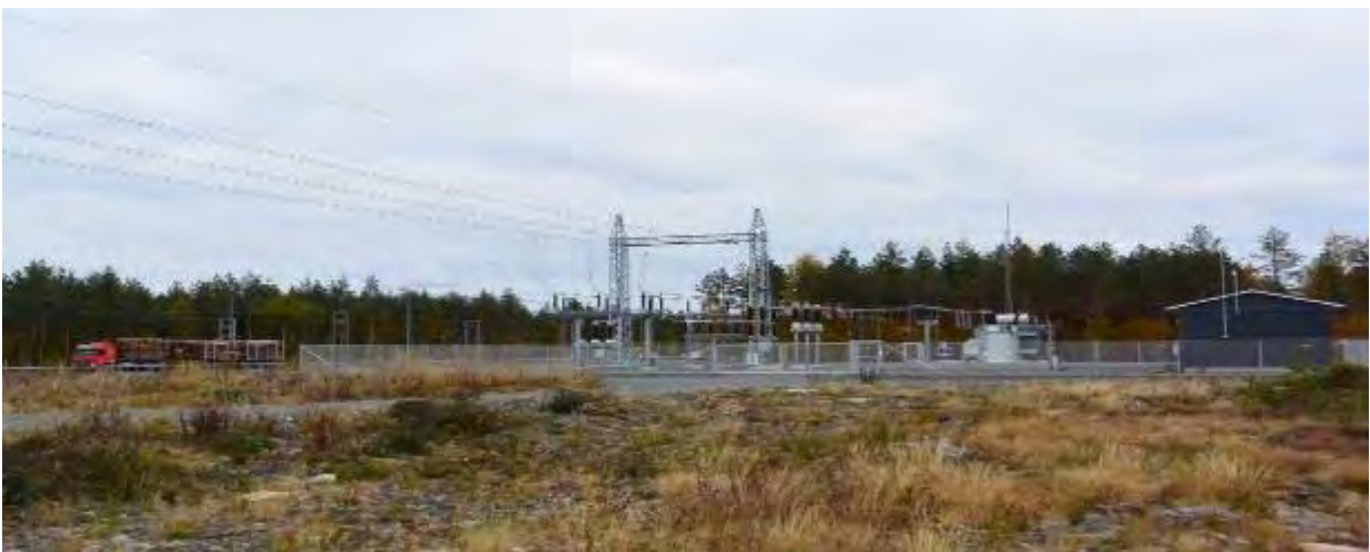
Kuva F. Sähköasema
